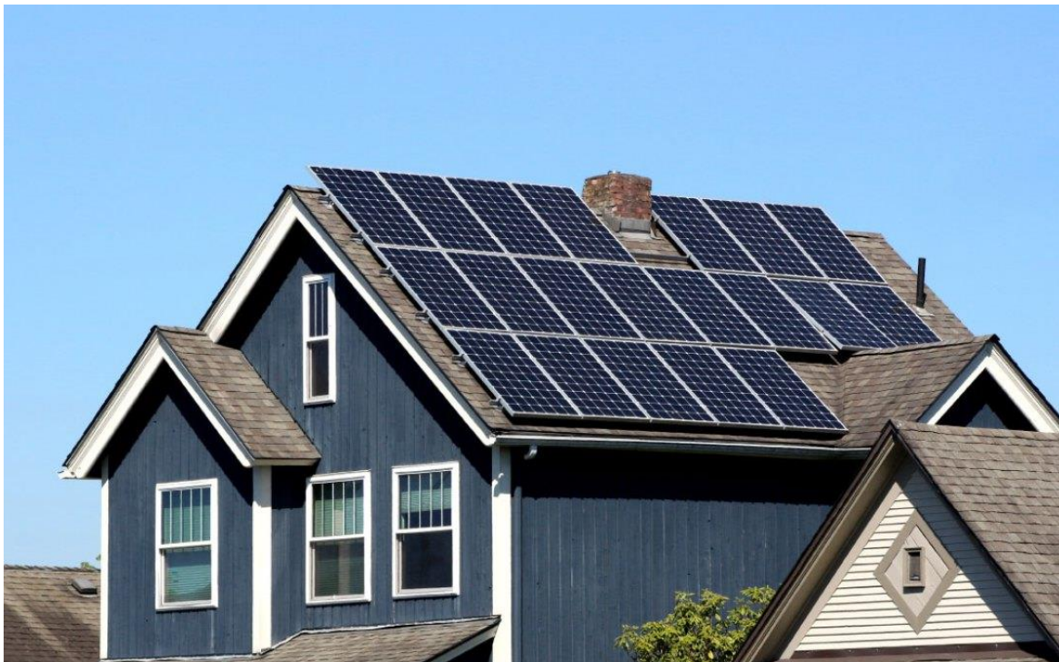
Sl 4.1. Fiksni fotonaponski sustav na krovu obiteljske kuće. Izvor [6]
