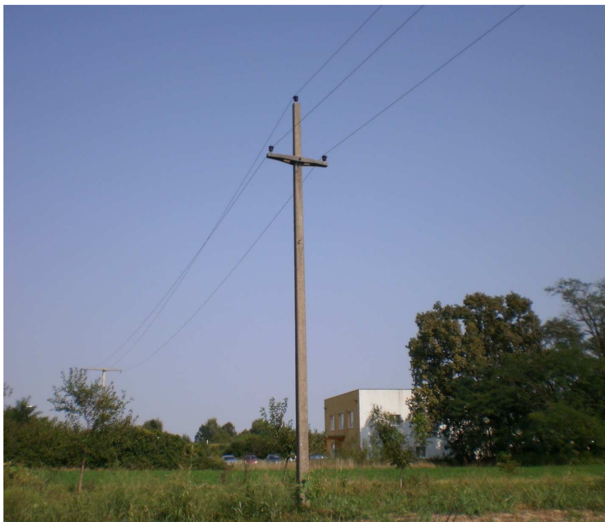
Sl. 2.16. Betonski stup 10 kV
