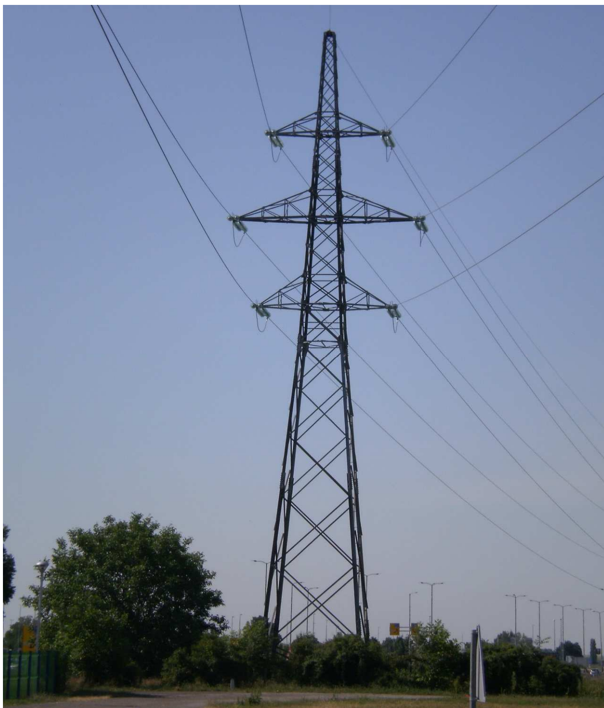
Sl. 2.14. Dvostruki čelično-rešetkasti stup 110 kV
