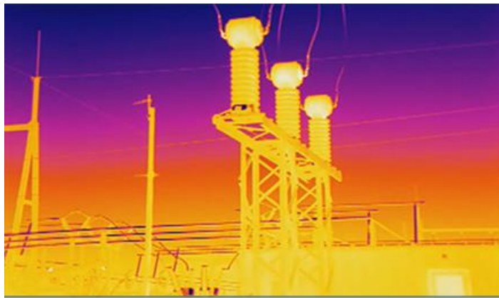
Sl. 4.3. Termografski snimak električnog voda
