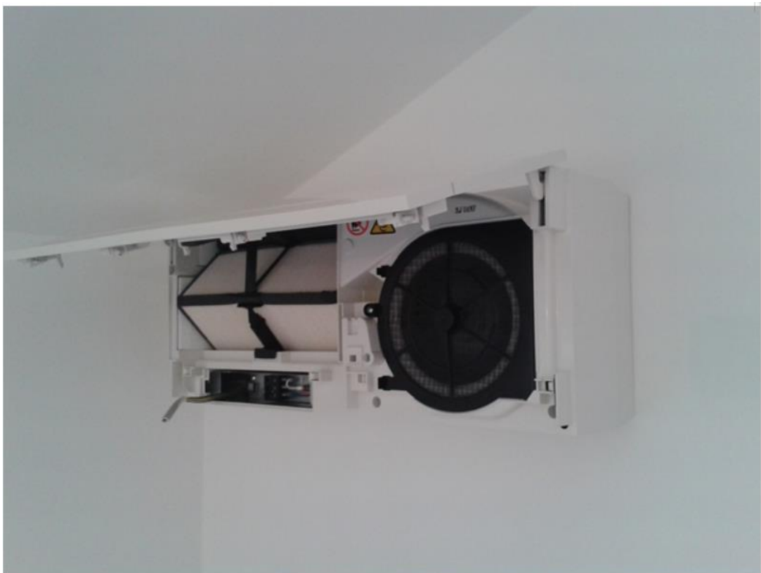
Slika 3.27 Otvorena montirana unutarnja rekuperacijska jedinica
