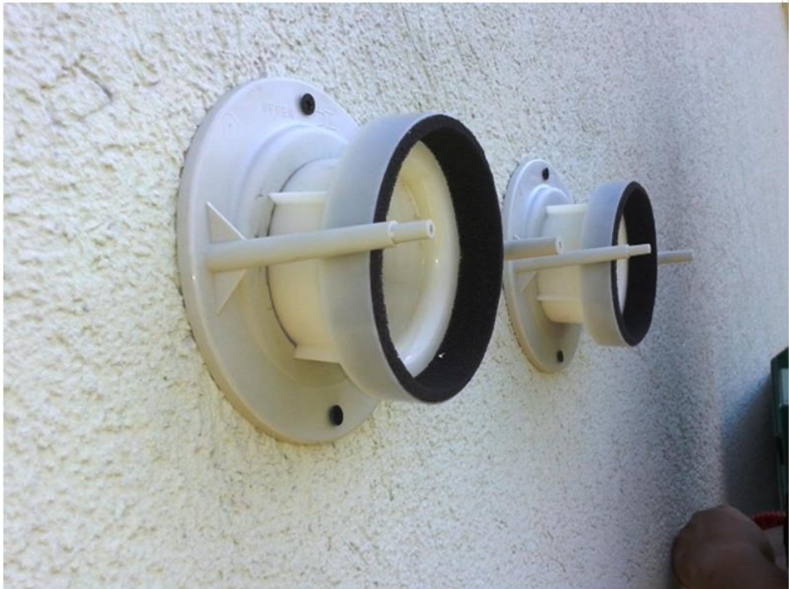
Slika 3.25 Izgled plastičnog završetka usisno/odsisnog kanala
