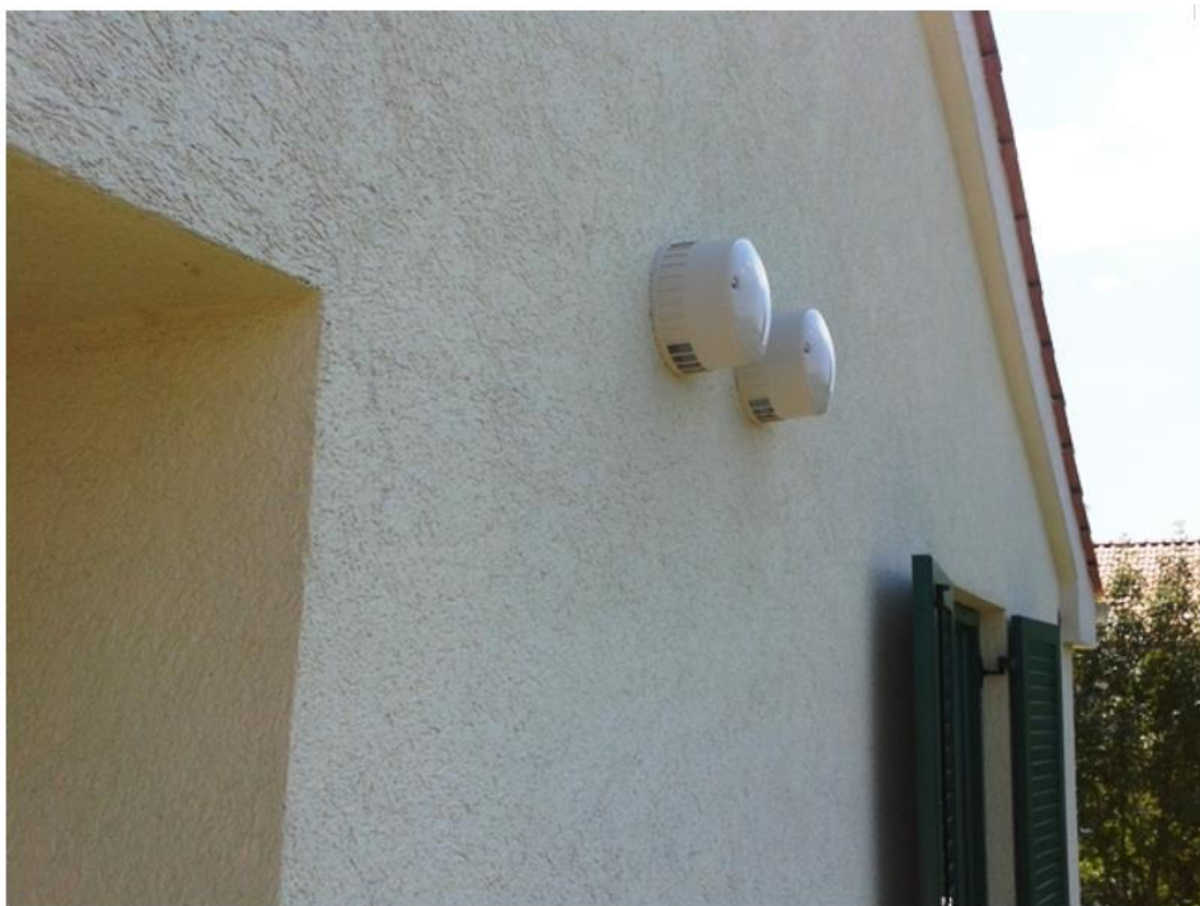
Slika 3.26 Finalni izgled rekuperatora s vanjske strane
