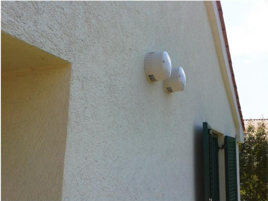
Slika 3.26 Finalni izgled rekuperatora s vanjske strane
