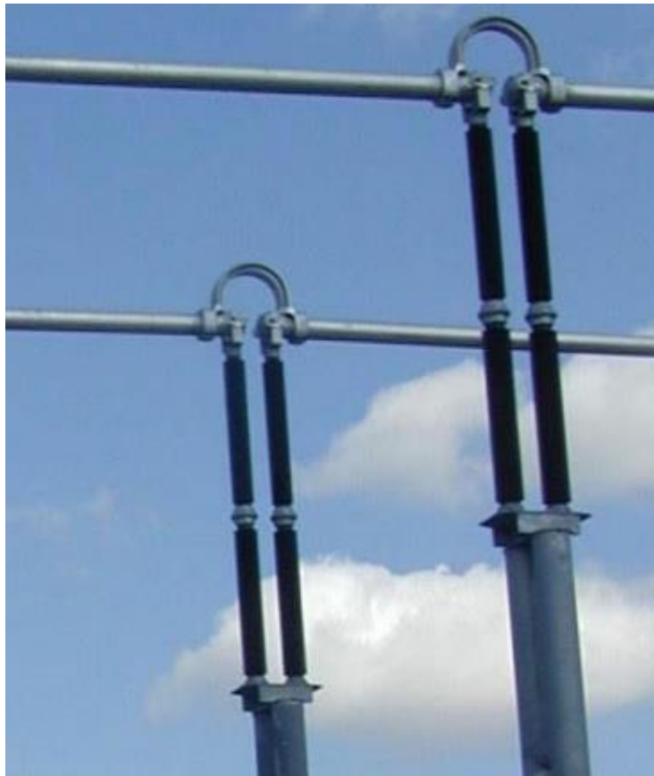
Slika 3.2. Potporni izolator na 400 kV-noj sabirnici [4]
