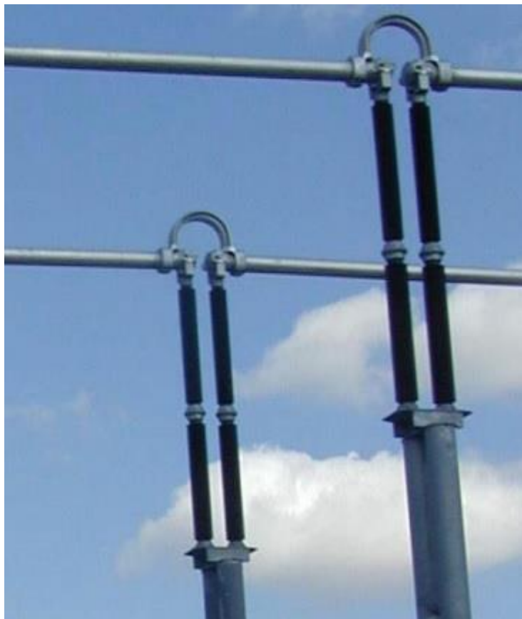
Slika 3.2. Potporni izolator na 400 kV-noj sabirnici [4]
