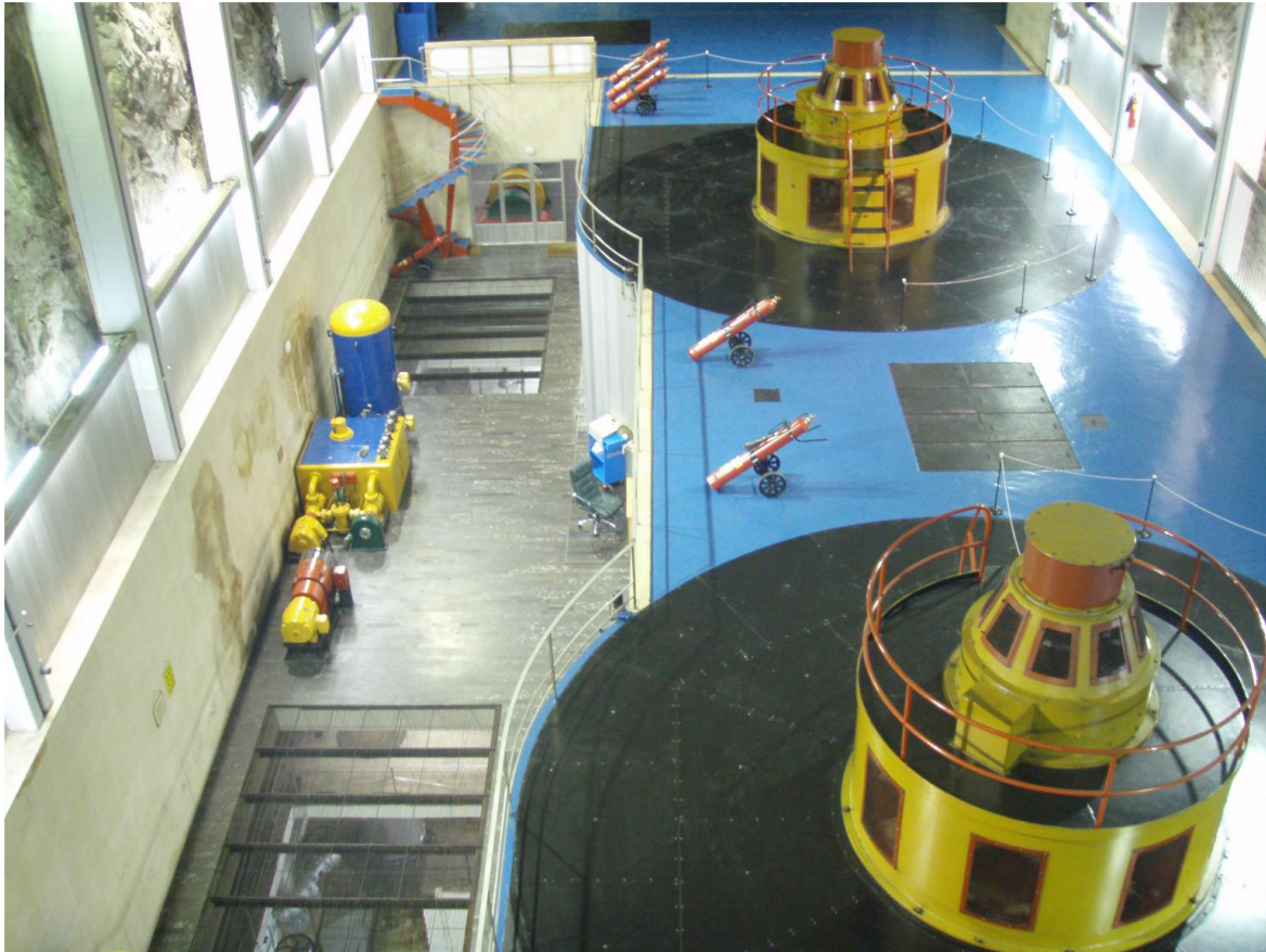
Slika 2.3. Fotografija sinkronih generatora 108 kV u HE Dubrovnik[1]
