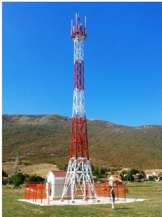
Sl. 3.2. Bazna postaja montirana na samostojeći stup
