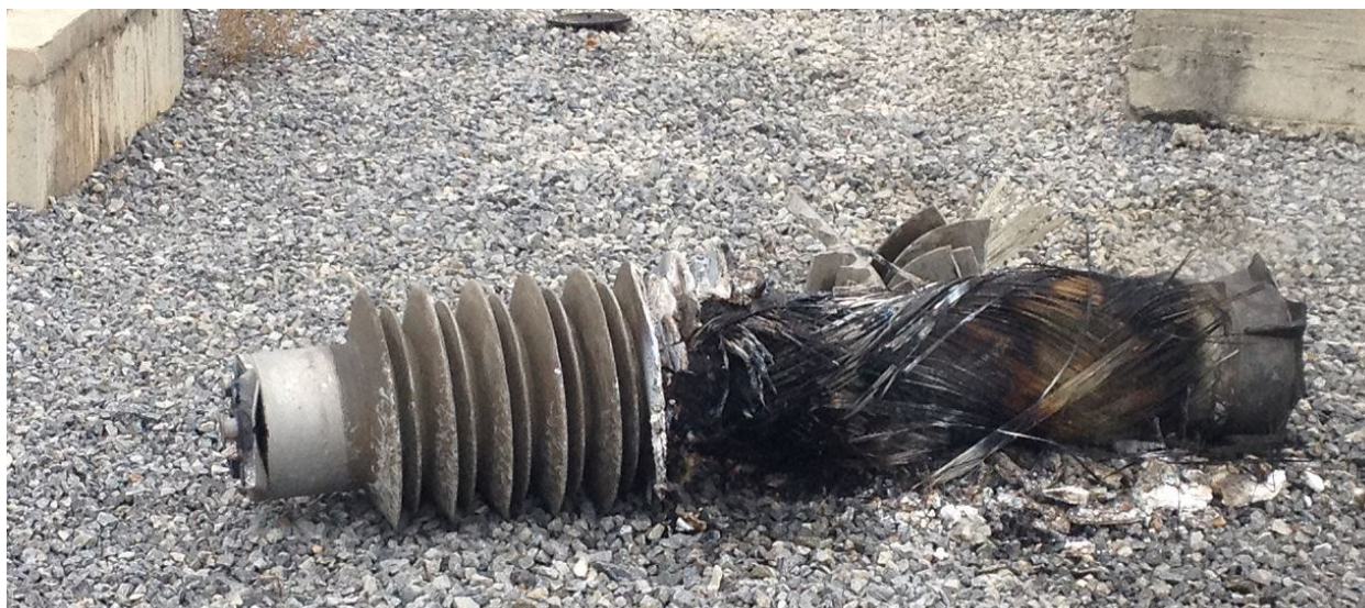
Slika 3.9. Dio mreže uništen visokom temperaturom električnog luka na sabirnicama u Ernestinovu
