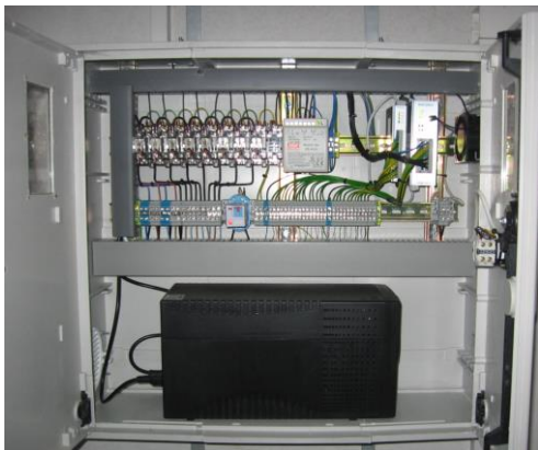
Sl.3.3.Razvodni ormar za daljinsko upravljanje TS-om
