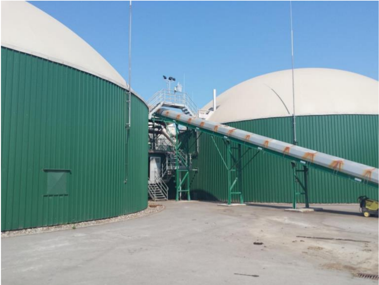
Slika 3.6. Digestor u bioplinskom postrojenju Mala Branjevina pored Osijeka [12]
