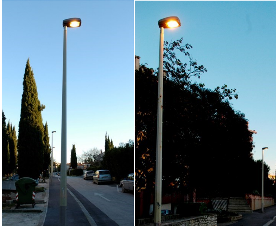
Slika 4.14. Rasvjetna tijela nakon rekonstrukcije u gradu Rovinju [8]
