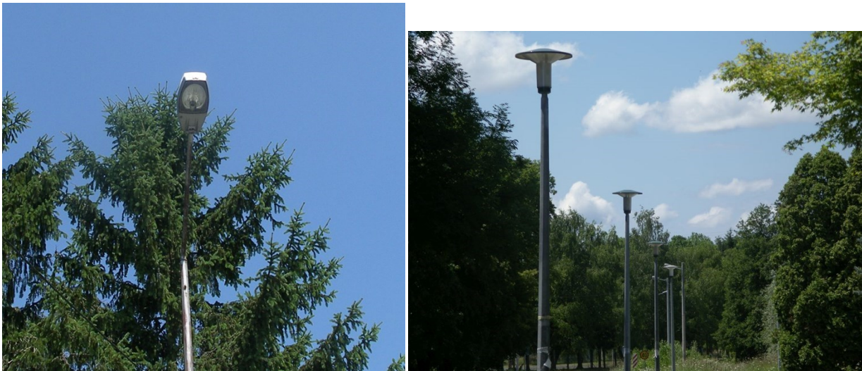
Slika 4.8. Modernizirana javna rasvjeta u gradu Jastrebarsko
