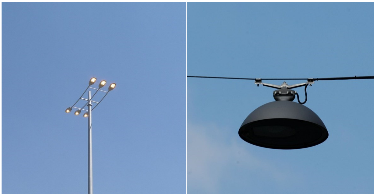
Slika 4.18. Javna rasvjeta grada Zagreba nakon modernizacije [8]
