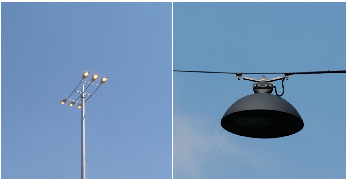
Slika 4.18. Javna rasvjeta grada Zagreba nakon modernizacije [8]
