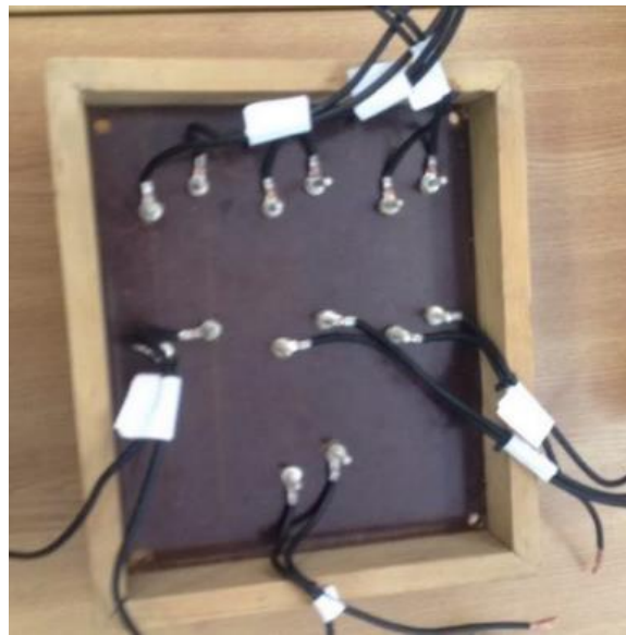
Slika 5.10. Ožičenje razvodne ploče
