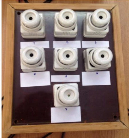
Slika 5.9. Razvodna ploča sa osiguračima
