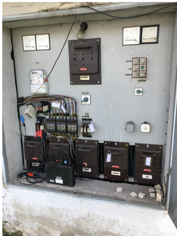
Slika 4.16. Zidna trafostanica PTTS 568
