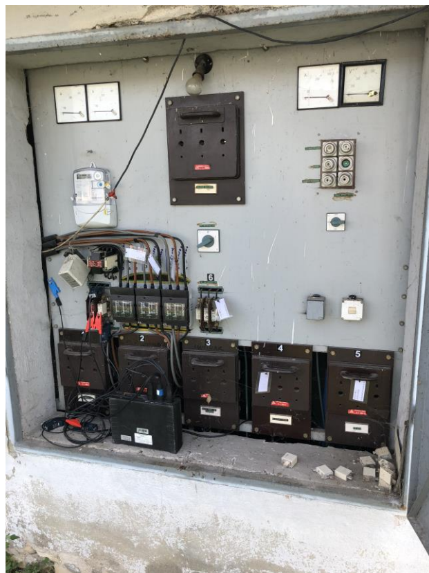
Slika 4.16. Zidna trafostanica PTTS 568
