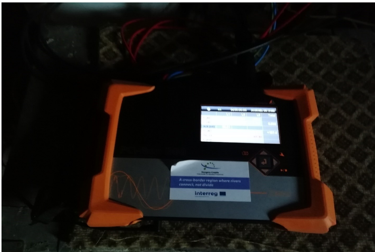
Slika 3.12. Mjerni uređaj A.Eberle PQ Box 200
