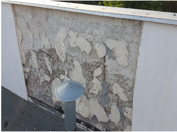
Slika 4.21. Oštećenja na krovu zgrade.
