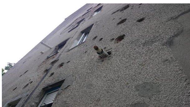
Slika 4.36. Jedan od fasadnih ispuha plinskih kombi bojlera.
