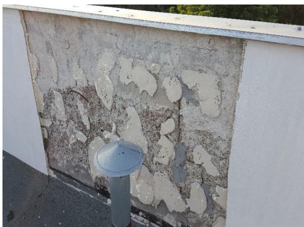
Slika 4.21. Oštećenja na krovu zgrade.
