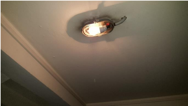
Slika 4.41. Rasvjeta zajedničkog komunikacijskog prostora (stubište).
