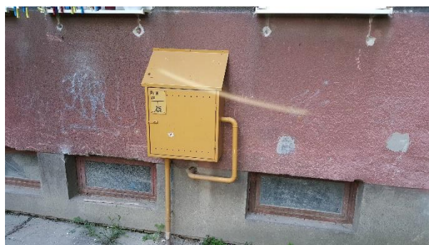
Slika 4.38. Glavni plinski priključni mjerni ormarić zgrade (MRS).
