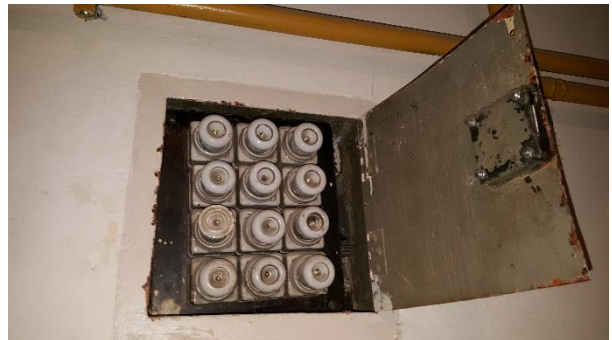
Slika 4.44. Karakteristični etažni razdjelni ormar.
