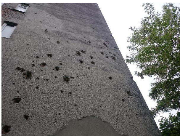
Slika 4.23. Oštećenja na fasadi.
