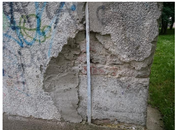
Slika 4.24. Oštećenja na fasadi.
