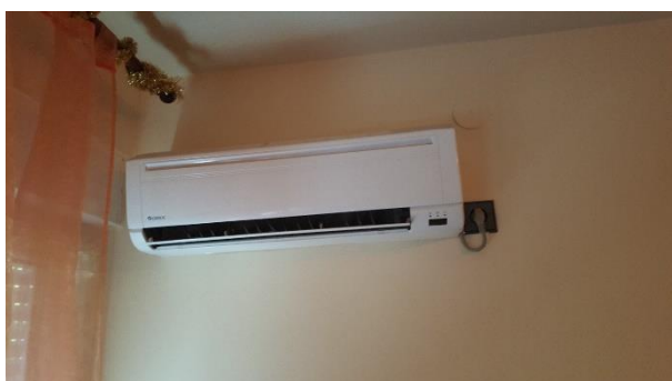
Slika 4.33. Jedan od split klima uređaja (unutarnja jedinica).
