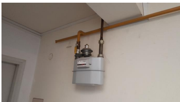
Slika 4.37. Jedan od plinskiх priključaka stambenih prostora.
