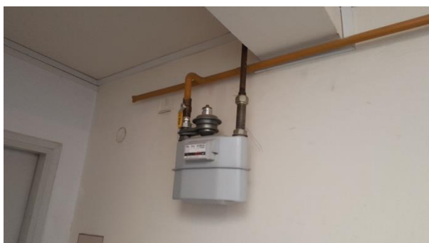
Slika 4.37. Jedan od plinskih priključaka stambenih prostora.
