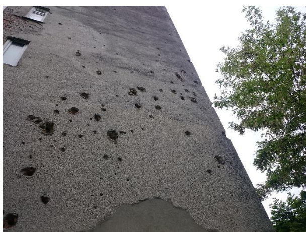
Slika 4.23. Oštećenja na fasadi.
