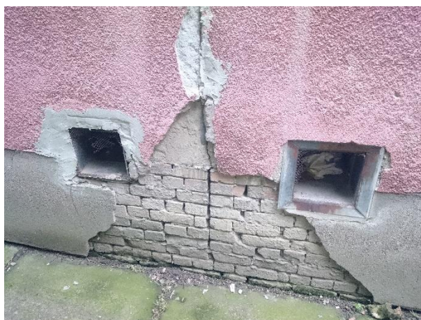
Slika 4.22. Oštećenja na cokol zidu podruma.
