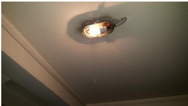
Slika 4.41. Rasvjeta zajedničkog komunikacijskog prostora (stubište).
