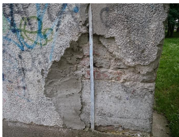
Slika 4.24. Oštećenja na fasadi.
