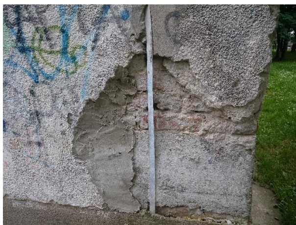
Slika 4.24. Oštećenja na fasadi.
