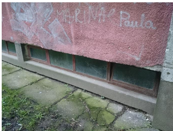
Slika 4.26. Oštećenja na otvorima (prozor podruma).
