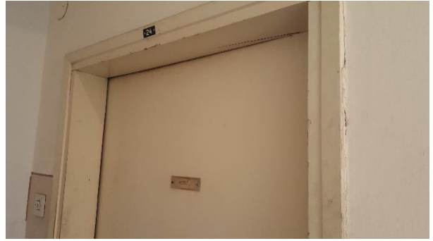
Slika 4.14. Karakteristični otvor zgrade D-D (ulazna vrata stambenog prostora).
