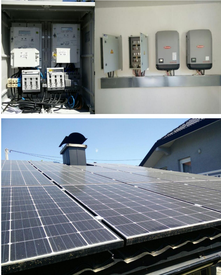
Slika 7.2. foto naponsko postrojenje i priključak na distribucijskoj mreži. Gore lijevo: AC ormar na stupu s mjernom i zaštitnom opremom. Gore desno: DC ormarić i izmjenjivači 2x10 kW.
