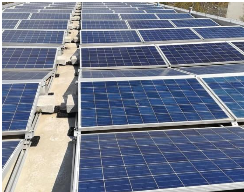
Slika 6.1. fotonaponska elektrana na kojoj je provedeno mjerenje
