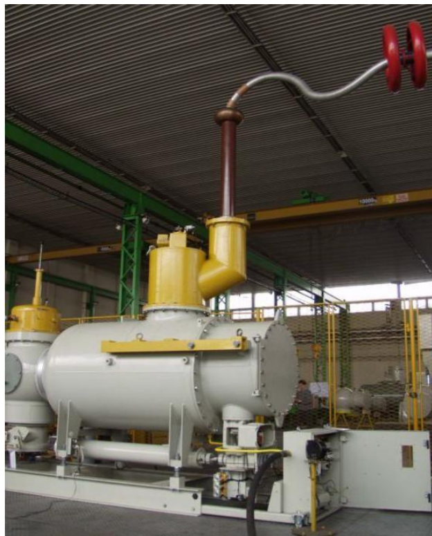
Slika 7.2 Ispitivanje funkcionalnosti visokonaponskog prekidača[1]
