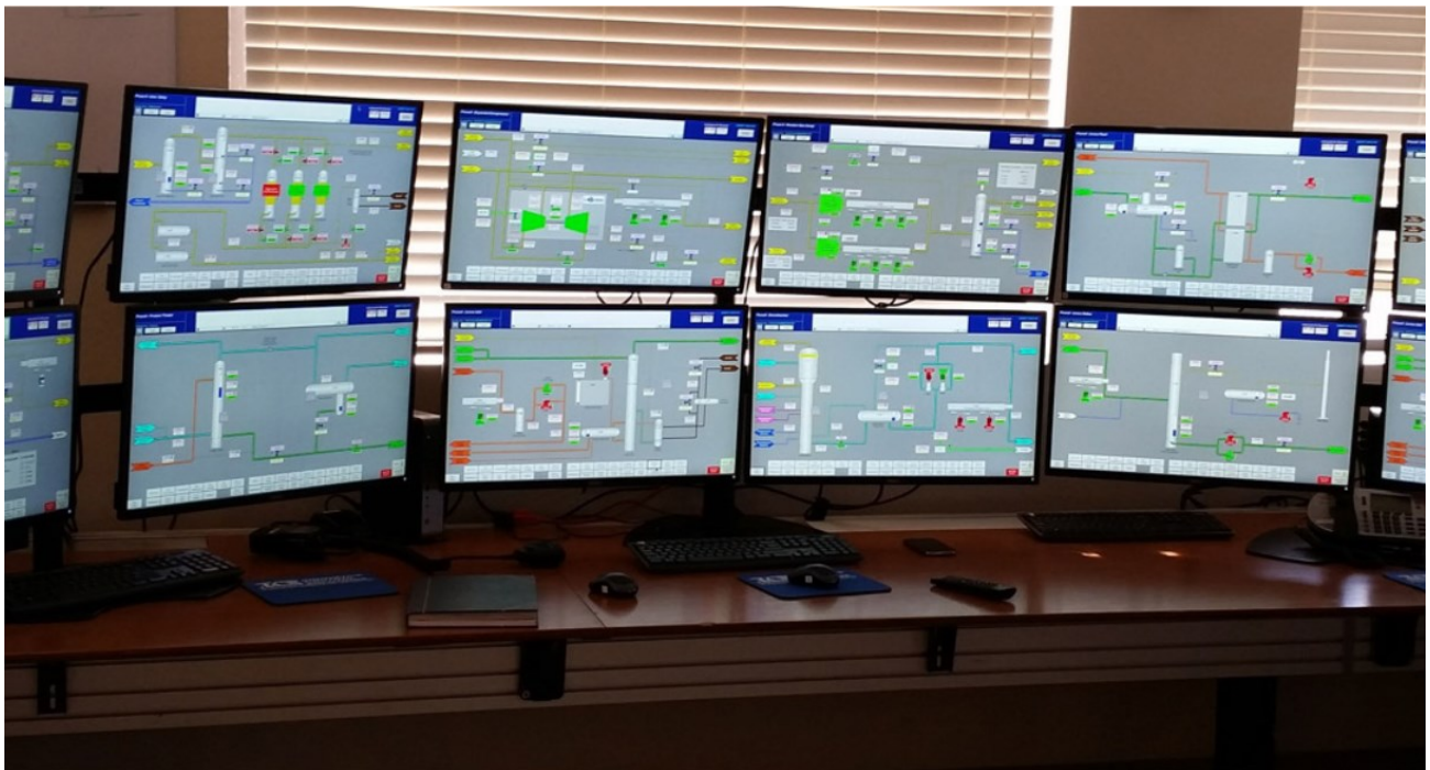
Slika 2.12. HMI kontrolna soba
