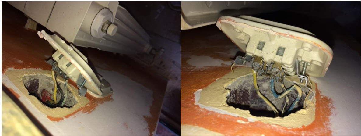
Sl. 5.3.3.1. Fotodokumentacija žica spojenih na prekidaču
