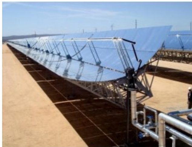
Slika 3.6. Postrojenje s paraboličnim žljebastim kolektorima [7]
