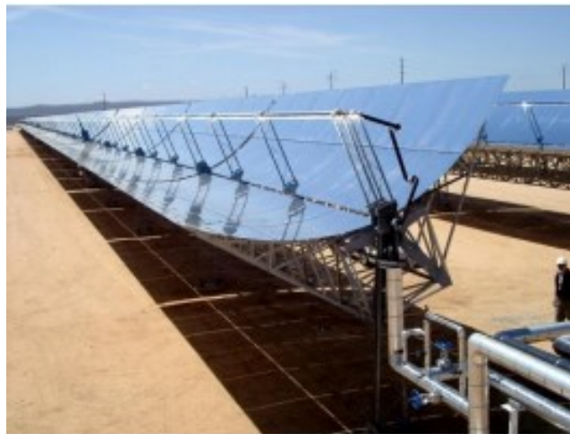
Slika 3.6. Postrojenje s paraboličnim žljebastim kolektorima [7]
