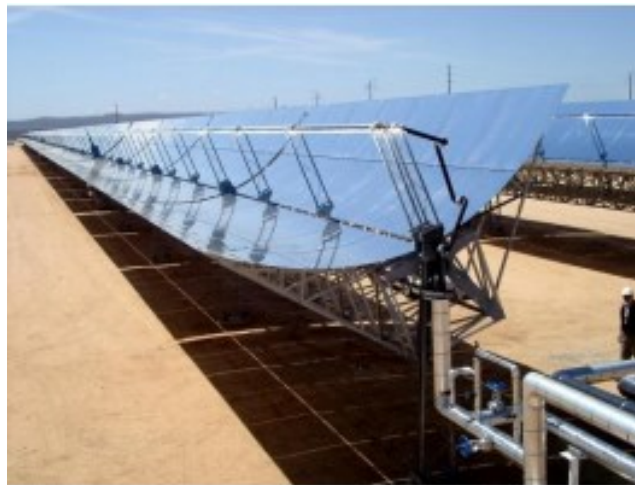
Slika 3.6. Postrojenje s paraboličnim žljebastim kolektorima [7]
