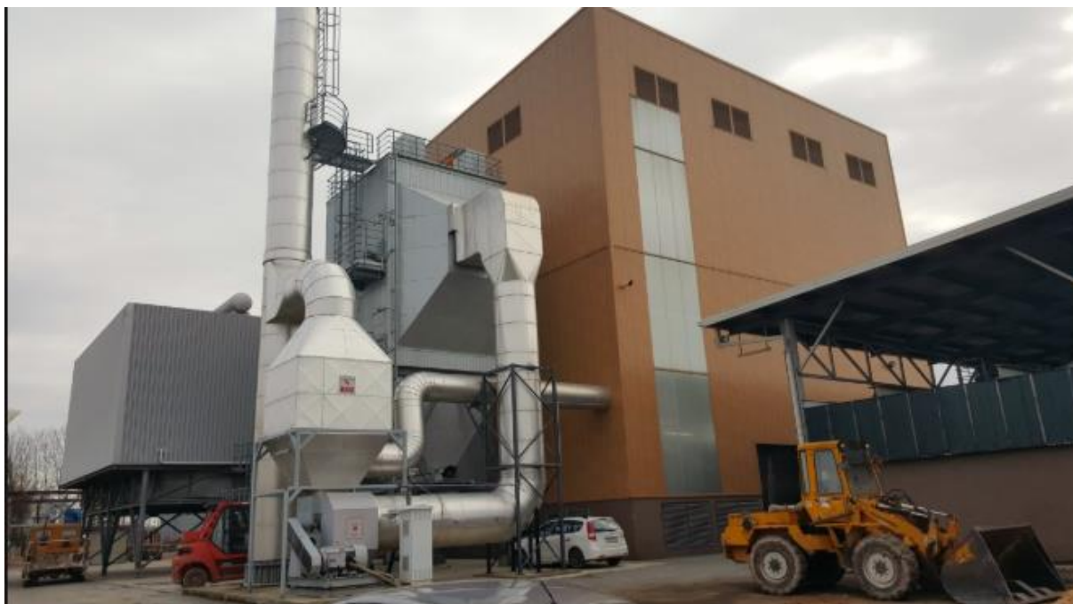
Slika 3.3. Elektrana na biomasu Hrast, Strizivojna koja koristi tehniku izgaranja za stvaranje pare [4]
