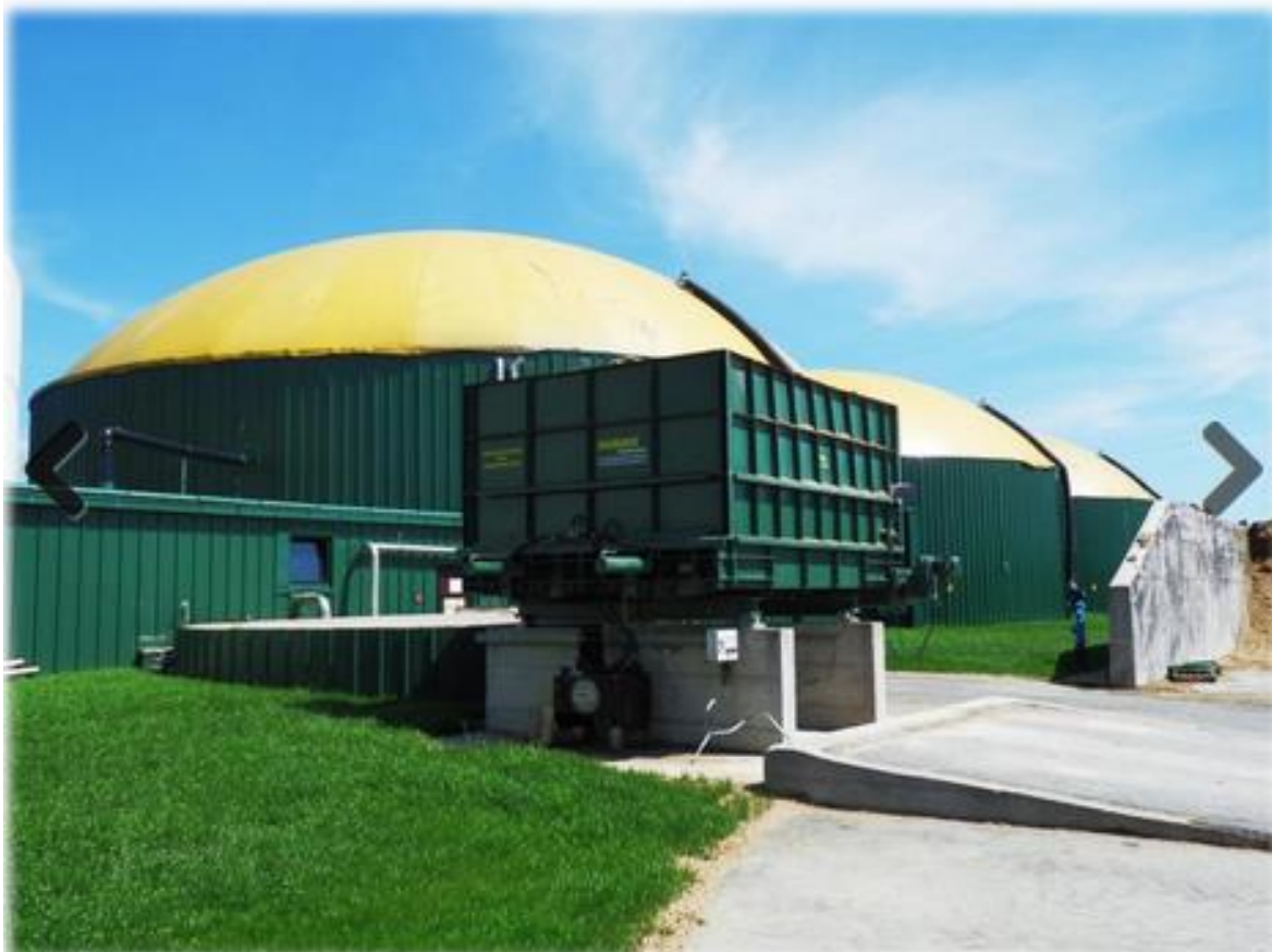
Slika 3.7. Bioplinsko postrojenje Ivankovo u kojem se razgrađuje otpad anaerobnom digestijom [6]
