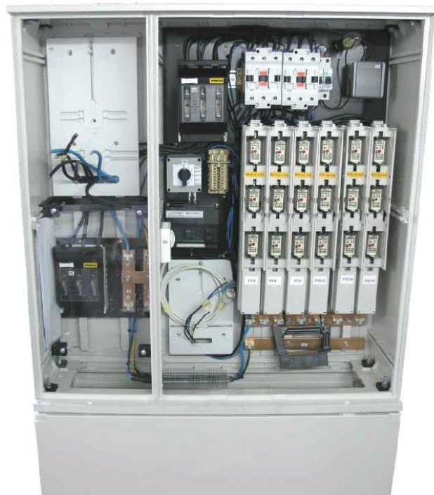
Slika 2.2. Slobodnostojeći razvodni ormar javne rasvjete [2].
