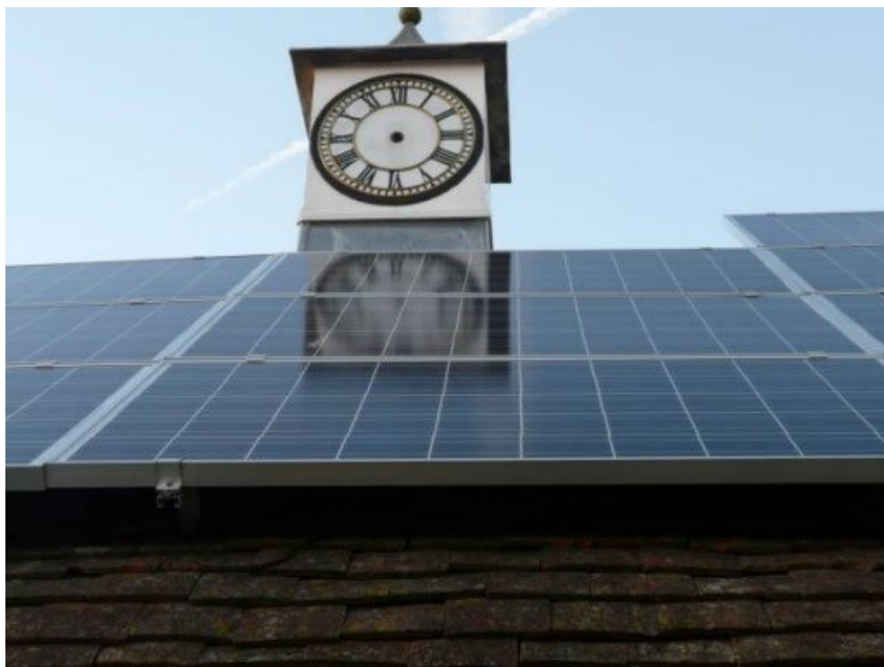
Slika 3.11. Trajno zasjenjenje fotonaponskih modula[9]
