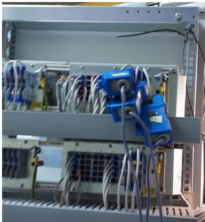
Slika 5. Spoj strujnih kliješta u strujnom ormaru
