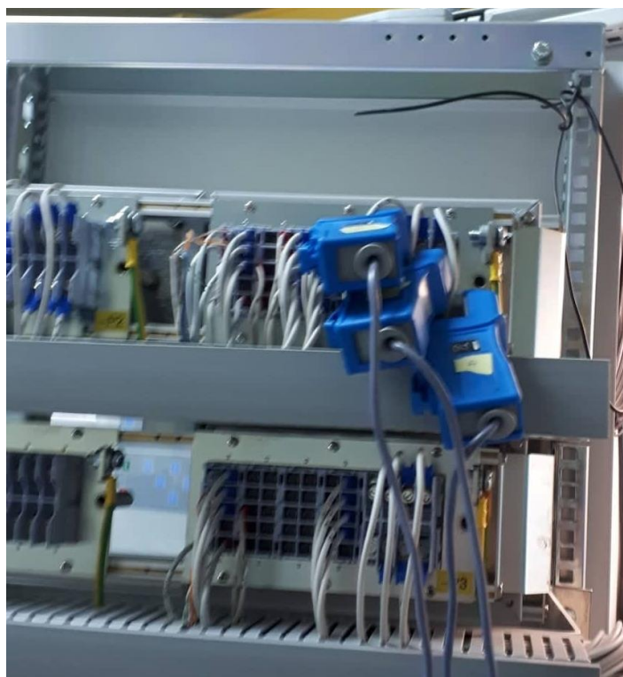
Slika 5. Spoj strujnih kliješta u strujnom ormaru
