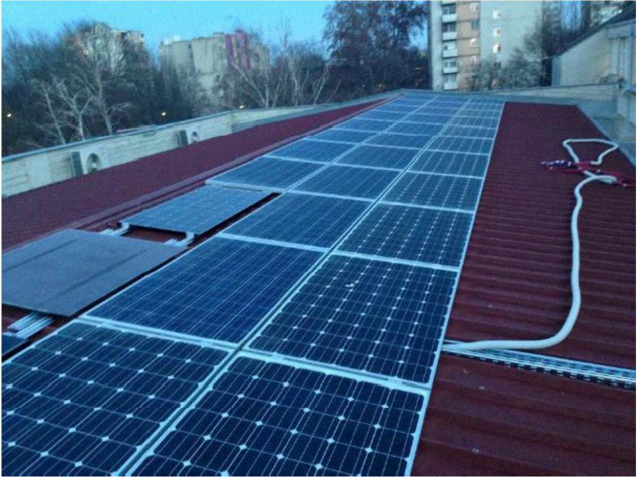
Slika 4.1. Fotonaponski moduli na krovu FERIT-a
