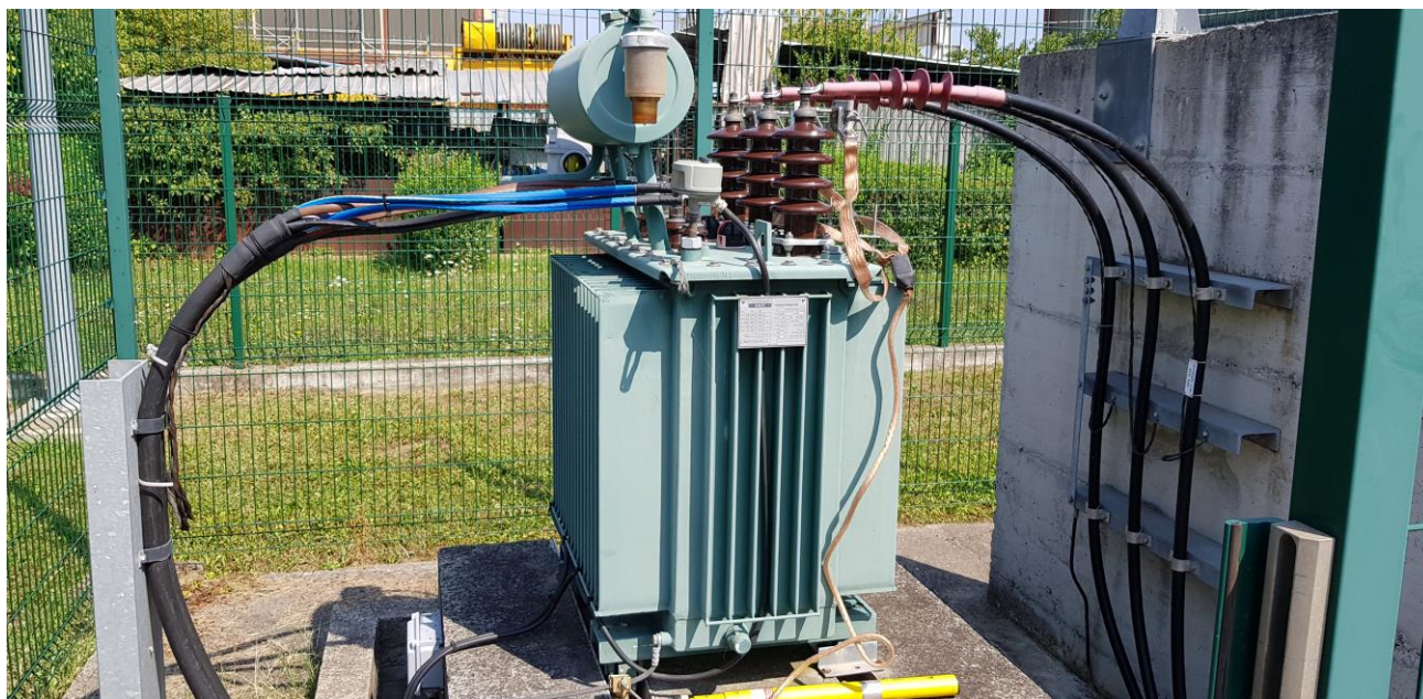
Slika 3.1. Transformator 10 / 0.4 kV, Elektra Slavonski Brod
