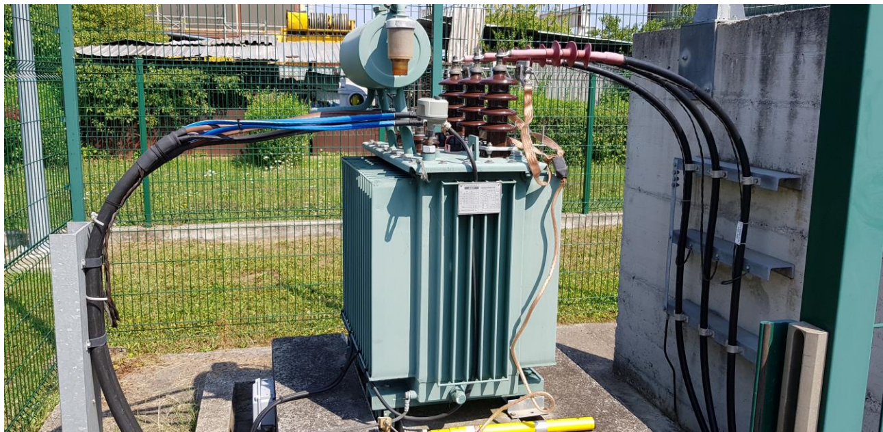
Slika 3.1. Transformator 10 / 0.4 kV, Elektra Slavonski Brod
