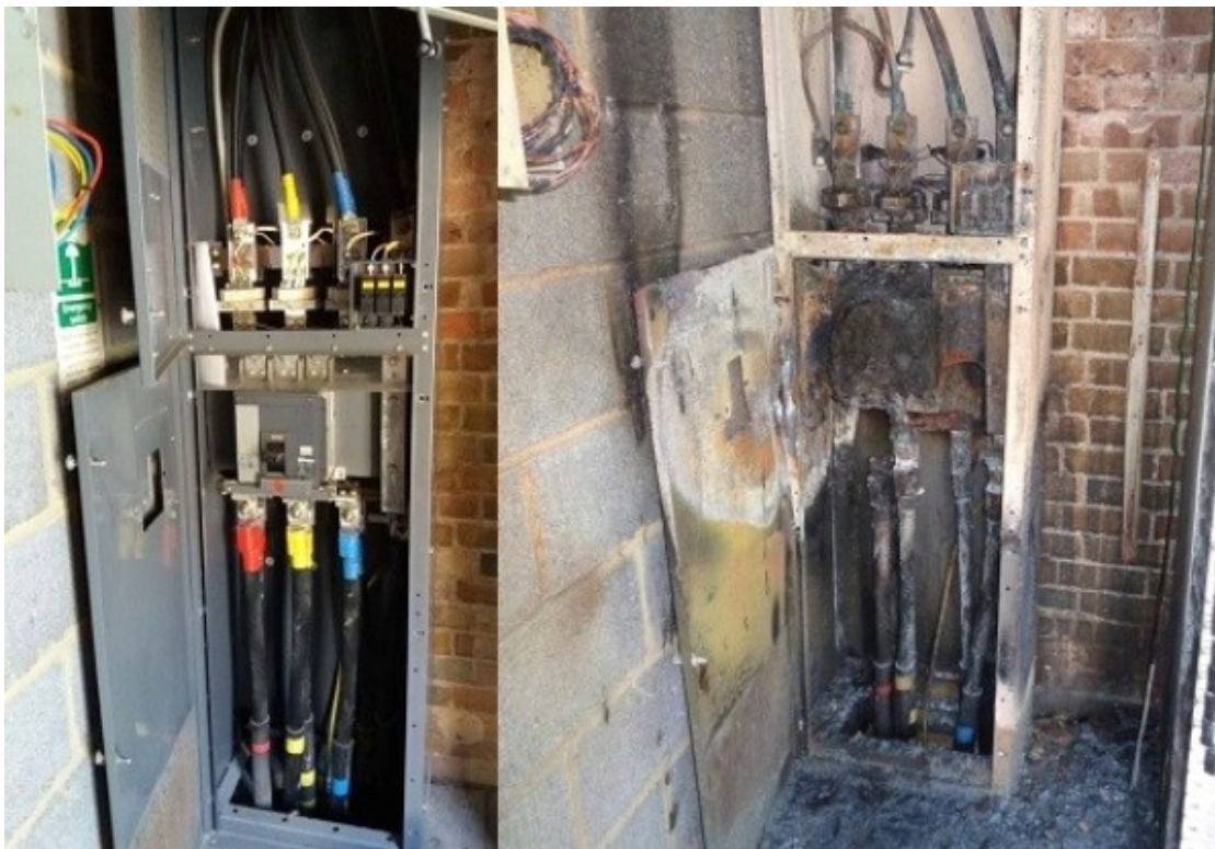
Slika 2.1. Instalacije nakon električnog luka. [1]
