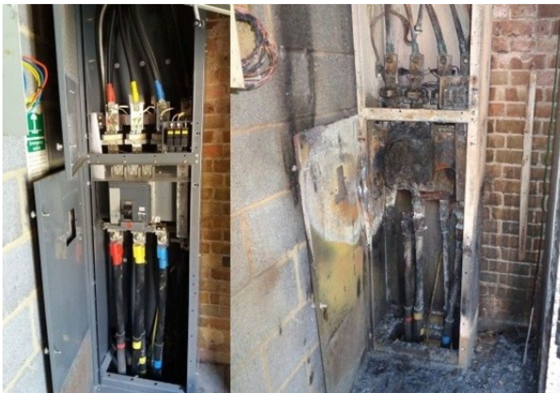
Slika 2.1. Instalacije nakon električnog luka. [1]
