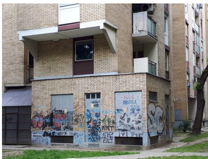
Slika 2.6. Distributivna trafostanica ugrađena u zgradu
