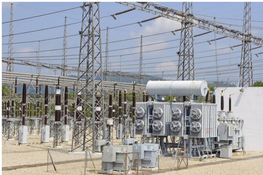
Sl. 3.2. Trafostanica za prijenos [4]
