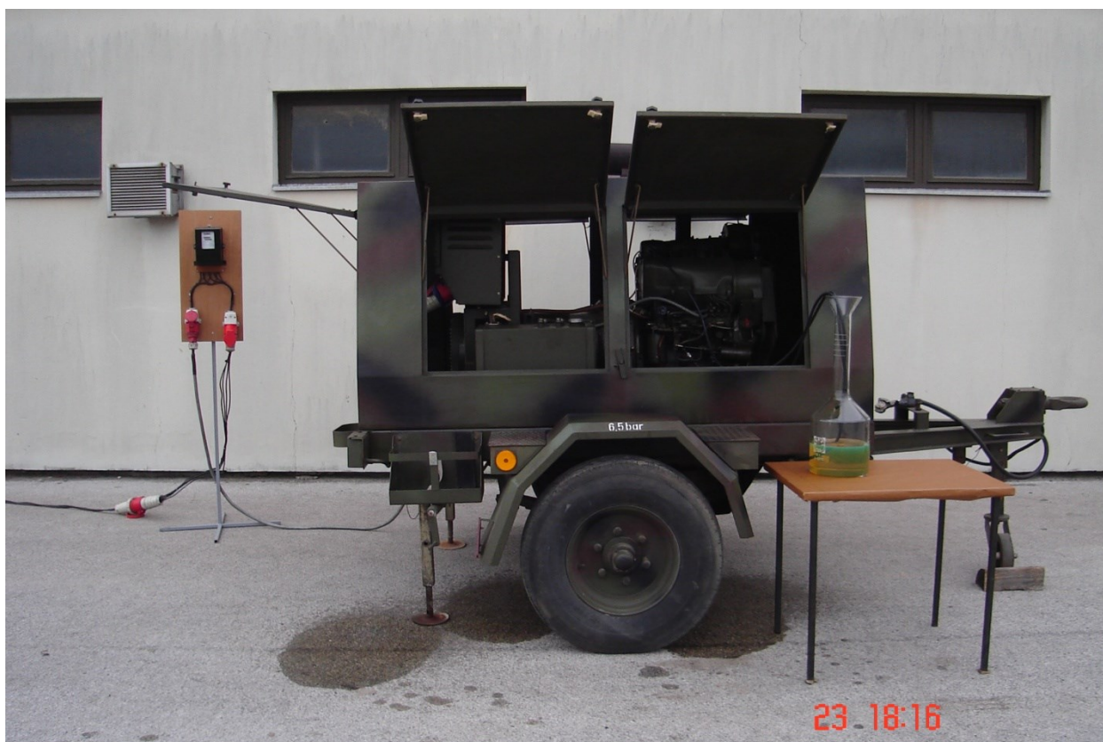
Slika 3.8. Ispitivanje elektroagregata za potrebe kategorizacije
