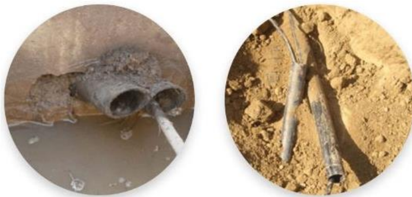
Slika 3.3: Stvarno stanje kabelske kanalizacije - posljedica neodržavanja, [13]
