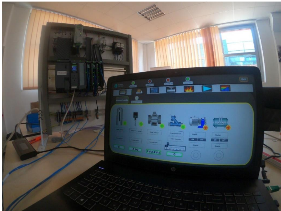
Slika 3.5 HMI povezan sa upravljačkim panelom
