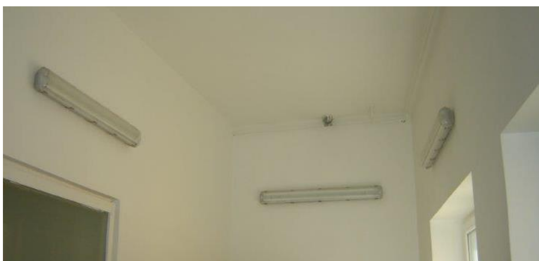
Slika 3.3. Trenutno stanje – rasvjeta u sanitarnim prostorima [19]
