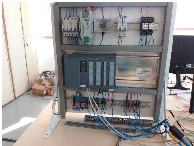
Slika 3.5 Razvodna ploča sa Siemens S7 – 1500 PLC-om za maketu održavanja temperature i razine tekućine u spremniku
