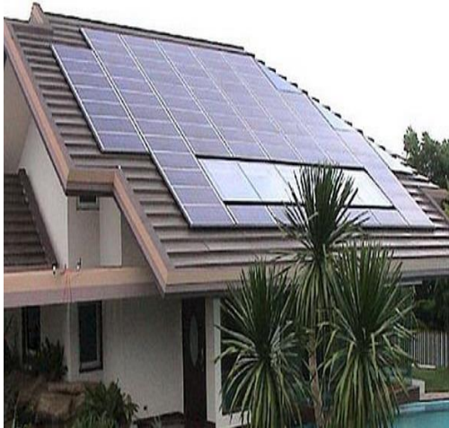
Slika 3.3. Solarni paneli na kući
