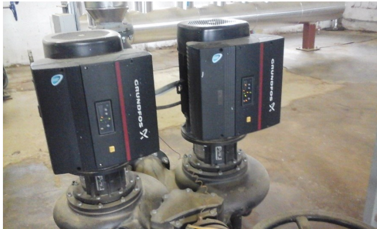
Slika 3.19. Pumpe za vodu
