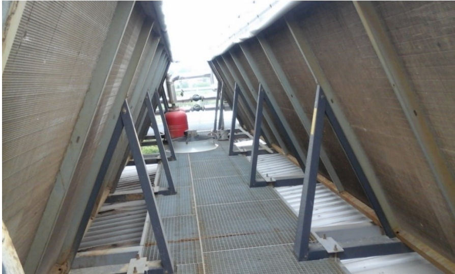
Slika 3.21. Hladnjaci na krovu postrojenja
