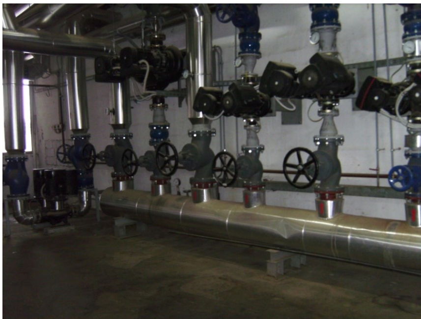
Slika 3.20. Pumpe za vodu koja ide prema potrošačima
