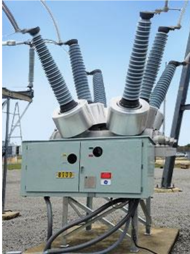
Sl.2.6. Dead-tank prekidač
