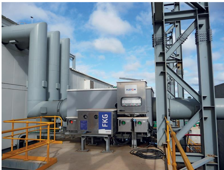
Sl.2.11 Generatorski prekidač
