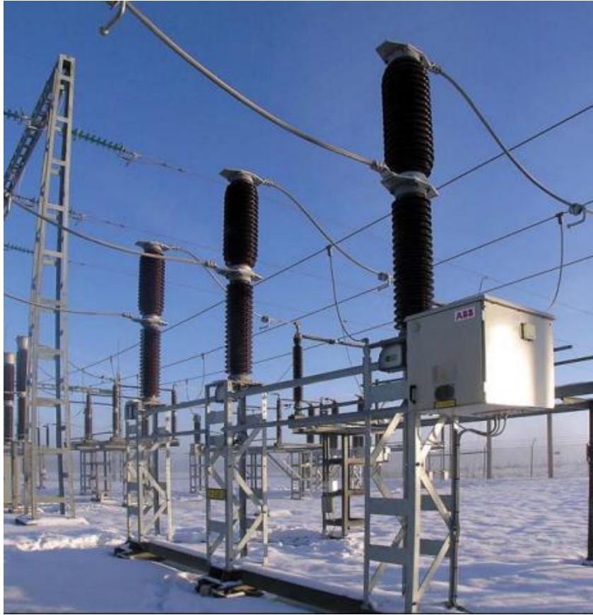
Sl.2.7. Live-tank prekidač
