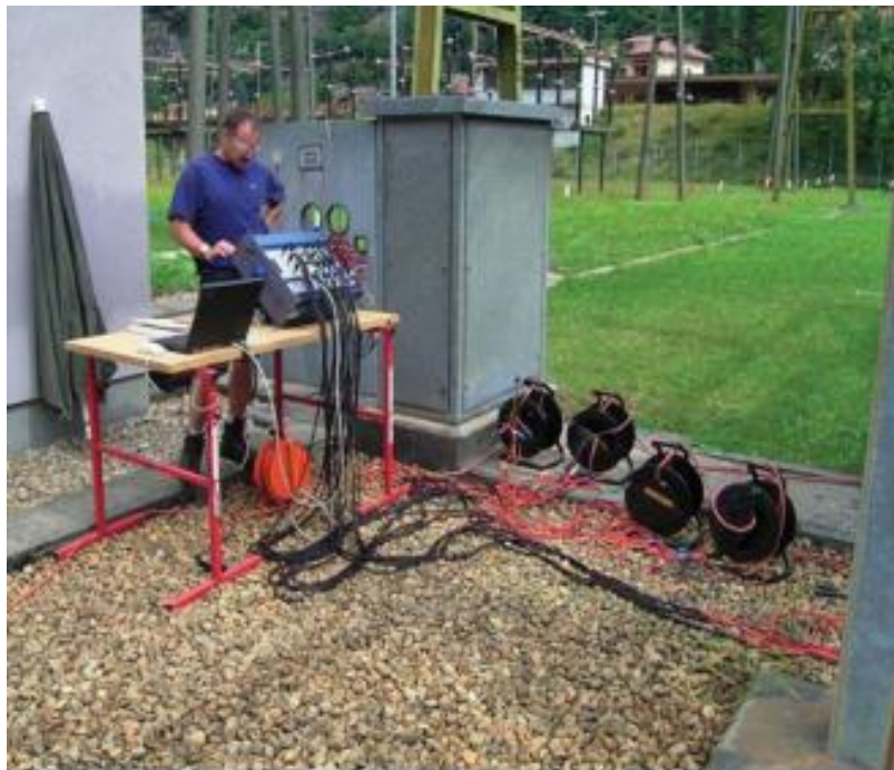
Sl.4.4. Prekidač spojen za ispitivanje
