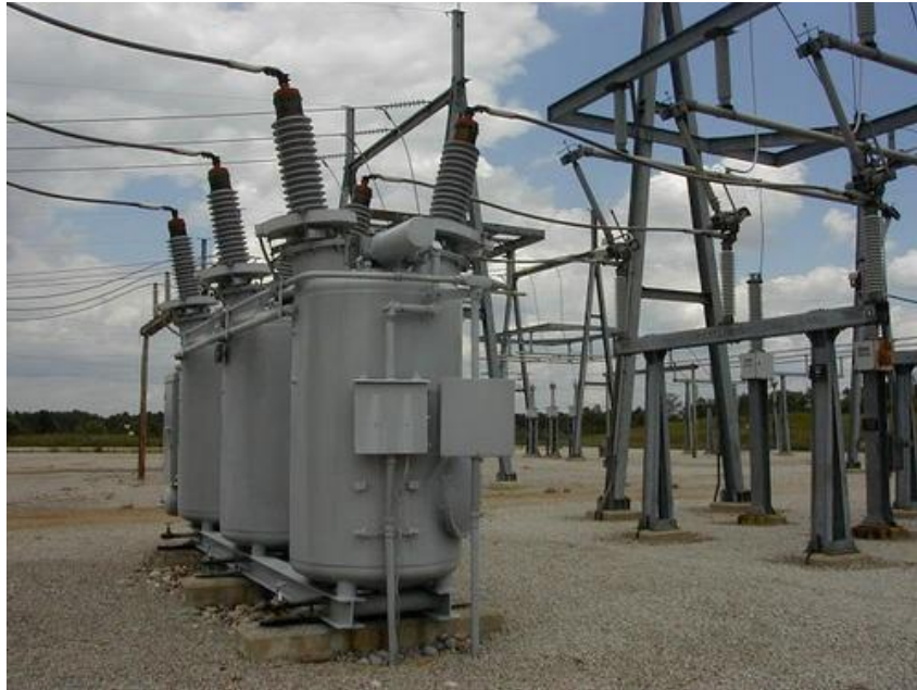
Sl.2.10 Transformatorski prekidač
