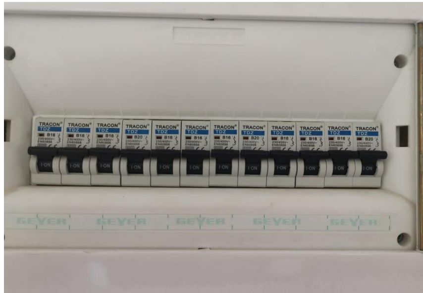
Slika 3.6: Podžbukna razvodna kutija sa automatskim osiguračima
