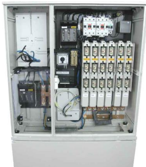
Slika 3.8. Slobodnostojeći razvodni ormar javne rasvjete [11]
