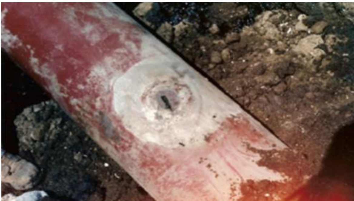
Slika 3.7. AC korozija cjevovoda [9]
