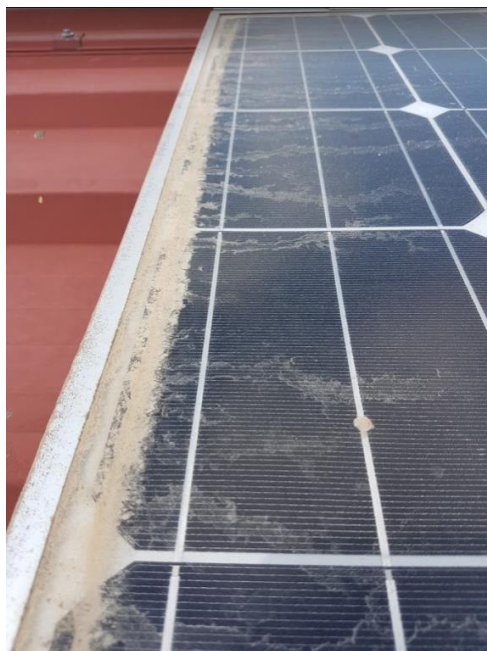
Slika 5.10. Donji rub panela sa akumuliranim slojem pijeska koji dovodi do zasjenjenja
