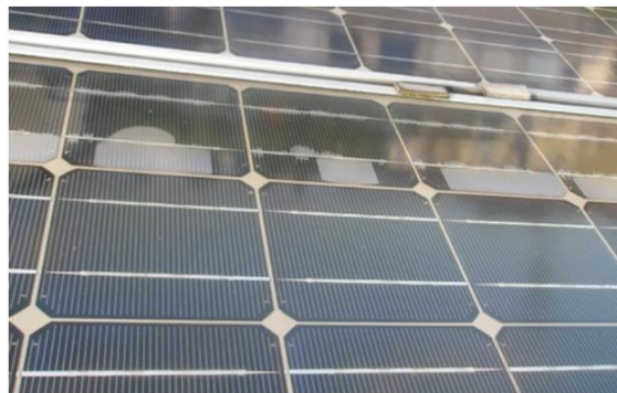
Slika 4.3.2.1. Delaminacija c-Si modula, izvor [16]
